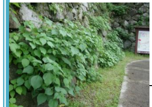
天守台の石積みの間に、蔓延る木根の成長による、崩壊を防ぐために、雑草に覆われた見つけられた
